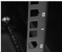
Perfiles de rack numerados
