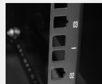
Perfiles de rack numerados
