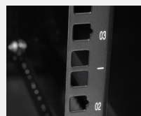
Perfiles de rack numerados
