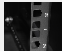
Perfiles de rack numerados
