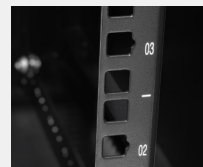
Perfiles de rack numerados
