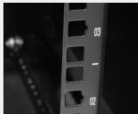
Perfiles de rack numerados
