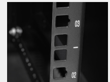
Perfiles de rack numerados
