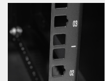
Perfiles de rack numerados
