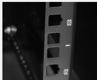
Perfiles de rack numerados
