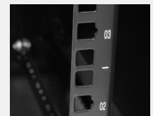
Perfiles de rack numerados
