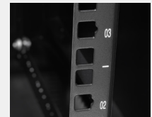
Perfiles de rack numerados
