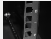
Perfiles de rack numerados
