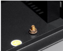
Toma tierra en puertas, superior e inferior
