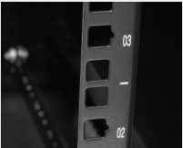
Perfiles de rack numerados
