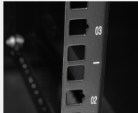
Perfiles de rack numerados
