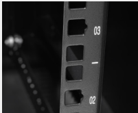
Perfiles de rack numerados
