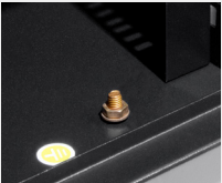
Toma tierra en puertas, superior e inferior
