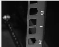
Perfiles de rack numerados
