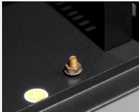
Toma tierra en puertas, superior e inferior
