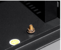
Toma tierra en puertas, superior e inferior
