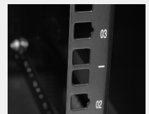
Perfiles de rack numerados
