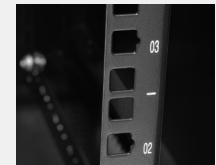
Perfiles de rack numerados
