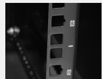
Perfiles de rack numerados
