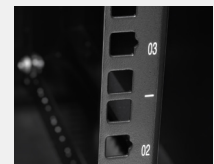
Perfiles de rack numerados
